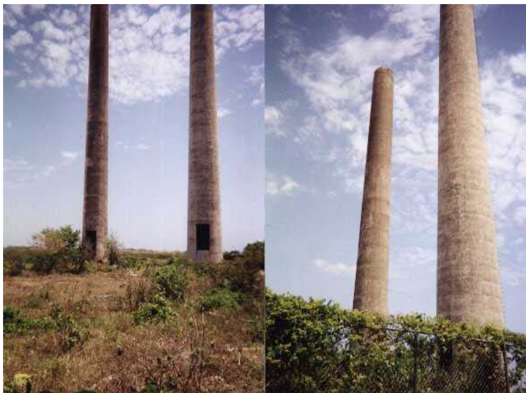
Figura III: Área de las chimeneas donde se colectó muestra (A2).
