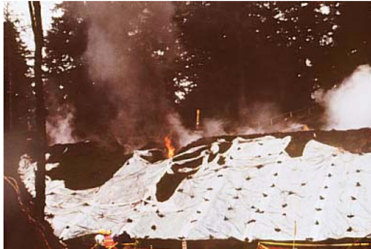
Figura 3- 19 Combustión espontánea en relleno con goma, carretera SR 100 Ilwaco, Washington. (Foto de Baker y otros, 2003)
